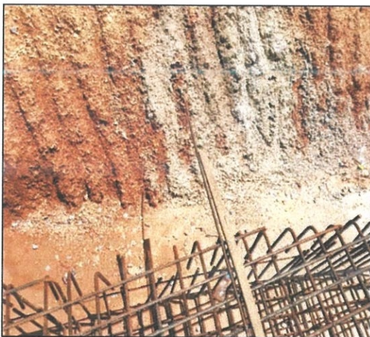
picture 3.7: actual distance of slab
