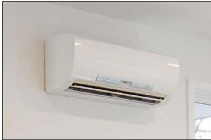
Figure 13: Ductless Mini Split
