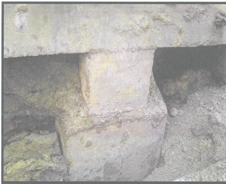
Gambar 3. 19: Runtuhan tanah pada bahagian struktur bangunan.
