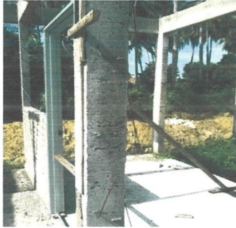
Gambar 3.17 : Kepingan besi pada tiang
