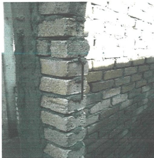
Gambar 3.16 : Kepingan besi pada dinding
