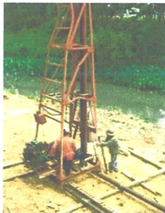
Gambar 3.1.5.6.5 Mesin 'A Frame'
