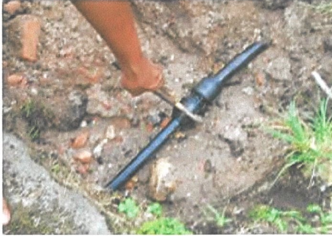
Gambarfoto 3.4 : Kebocoran Pada Paip Sambungan
