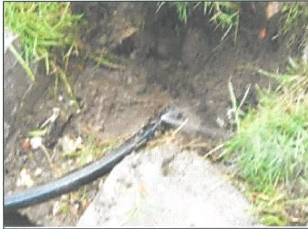
Gambarfoto 4.4 : Bocor pada Paip Perkhidmatan
