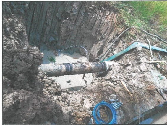
Gambarfoto 4.2 : Kebocoran pada Paip Utama
