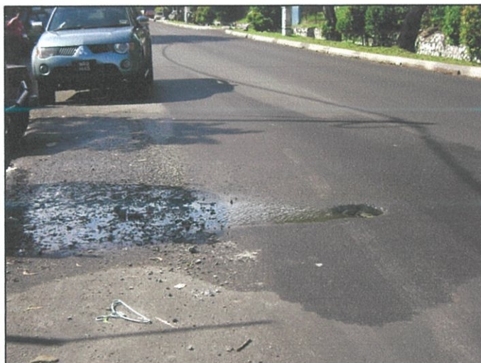
Gambarfoto 3.3 : Kesan Kebocoran Pada Permukaan Jalan
