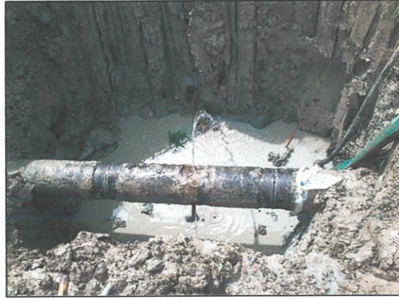
Gambarfoto 4.1 : Kebocoran pada Paip Utama
