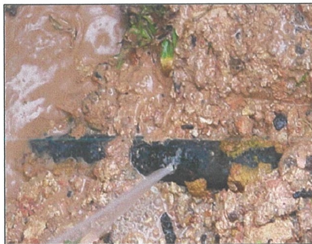
Gambarfoto 4.3 : Bocor pada Paip Perkhidmatan
