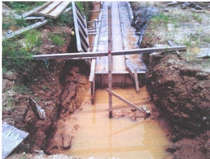
Gambarfoto 4.6: Kerja-kerja pembinaan longkang tergendala akibat takungan air hujan.
