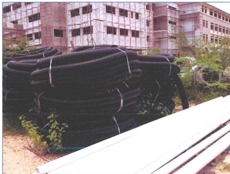
Gambarfoto 4.12: Stor terbuka untuk meletakkan barang-barang yang memerlukan ruang yang banyak seperti paip uPVC
