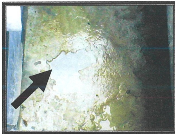
Gambar Foto 4.7 : Lubang Pada Longkang
