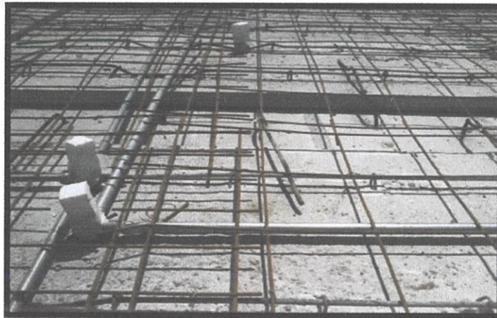
Gambarfoto 4.10: Paip Perkhidmatan Elektrik
