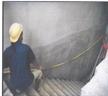
Foto 5.3 pita pengukur yang tidak tegang
