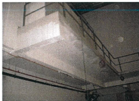
Gamabar Foto 3.3 : Limpahan air hujan yang masuk ke dalam Bangunan pada 24 febuari 2012.
