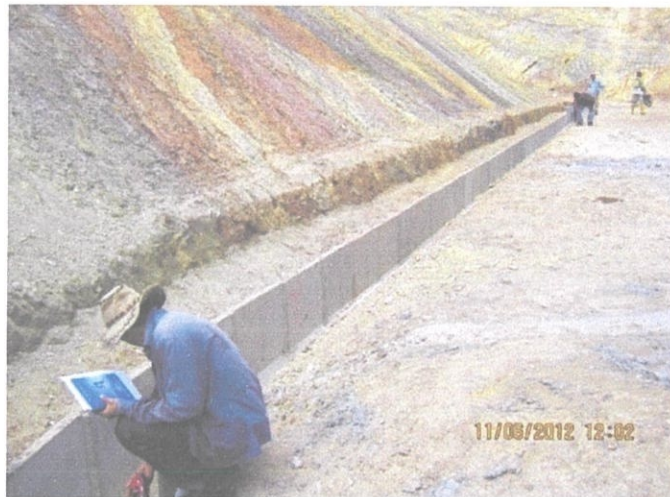
Gambar 2.6: Saliran Longkang di tapak bina SMK Forest Bayu, Seremban.
