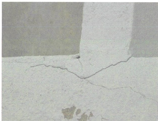
Gambar 3.3: Keretakan struktur di tapak bina Forest Bayu, Seremban.
