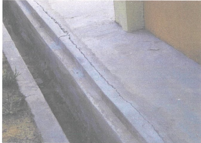
Gambar 3.8: Keretakan Lantai Konkrit di Tapak Bina Forest Bayu, Seremban.
