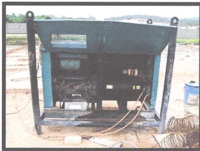
Gambarfoto 4.10: Kelengkapan Pemateri (Welding Set)
