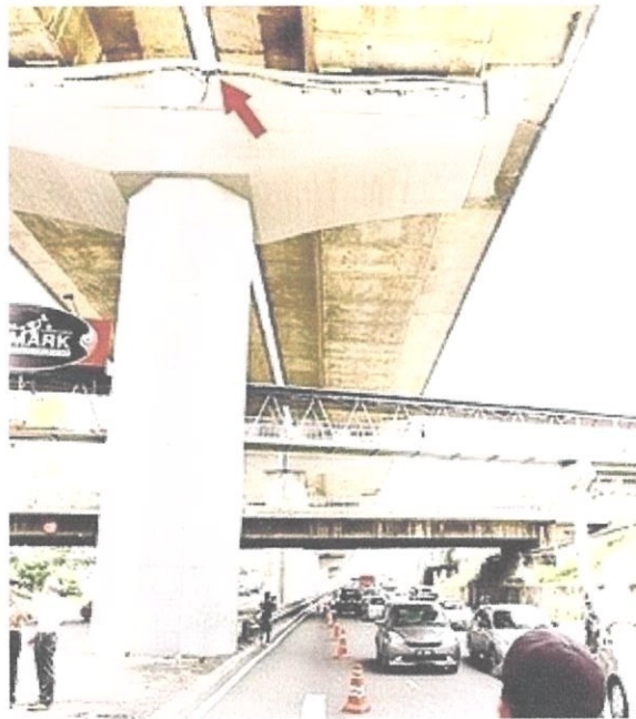
Gambarfoto 3.22: Anak Panah Menunjukkan Keretakan Pada Struktur Rasuk Jejambat
