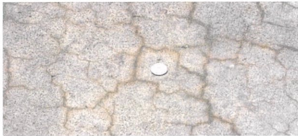
Gambarfoto 3.5: Keretakan akibat tindak balas silika-alkali dalam konkrit
