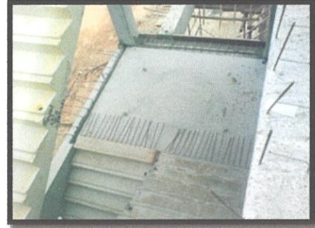
Gambar 3.16 : Keadaan tangga sebelum kaedah grouting
