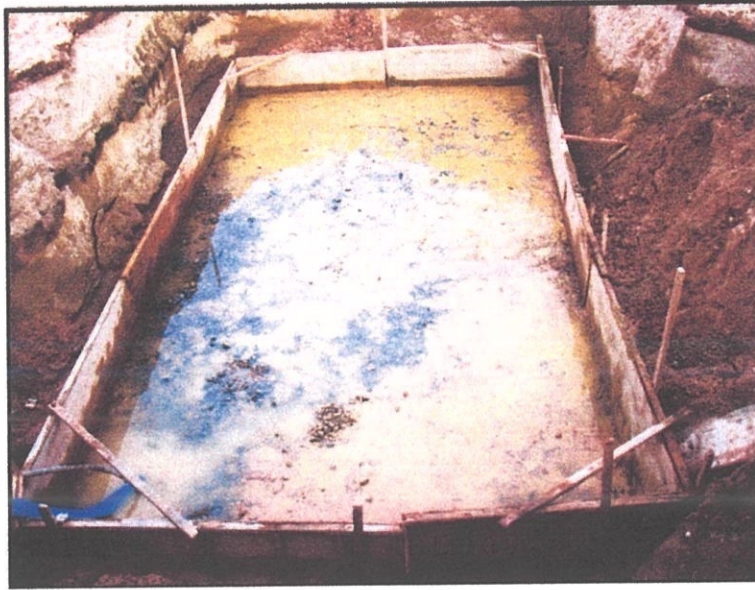
Gambarajah 5.3.2: Menunjukkan kerja-kerja pemasangan kotak acuan dan juga menghamparkan ‘crusher run’ serta ‘leanconcrete’ yang telah siap dijalankan setelah air dipam.
