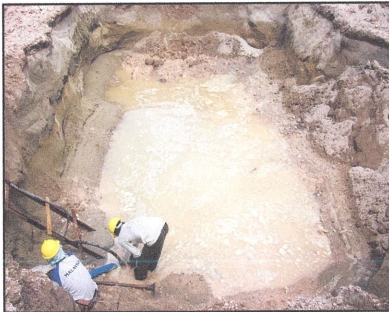
Gambarajah 5.2.1: Menunjukkan air yang bertakung dari bawah tanah
