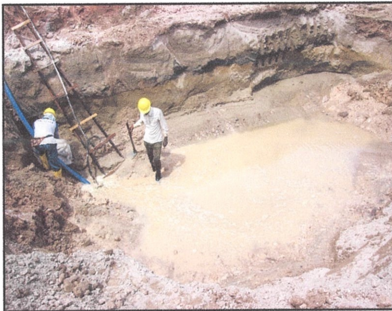
Gambarajah 4.4.5.1 Menunjukkan Air yang bertakung
