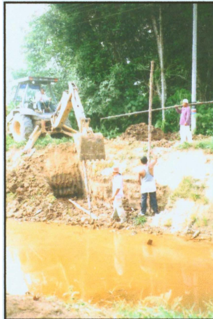
R.C7: KERJA PENANAMAN CERUCUK BAKAU BAGI PEMBINAAN JAMBATAN DENGAN MENGGUNAKAN JENTERA JENKKAUT. (PROJEK PEMBINAAN TASKA KG BARU, SRI GADING BATU PAHAT JOHOR)
