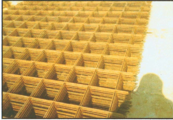
R.E3: KEPINGAN JEJARI KELULI (mesh reinforcement/BRC) (PROJEK PEMBINAAN TASKA, KG. BARU, SRI GADING BATU PAHAT JOHOR)
