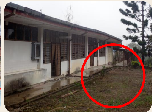
Gambar 10: Salah sebuah bangunan di SMK Kundasang yang rosak teruk akibat kegagalan struktur tanah
