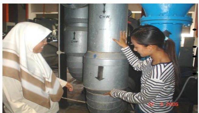
Chiller CHWR and CHWS
