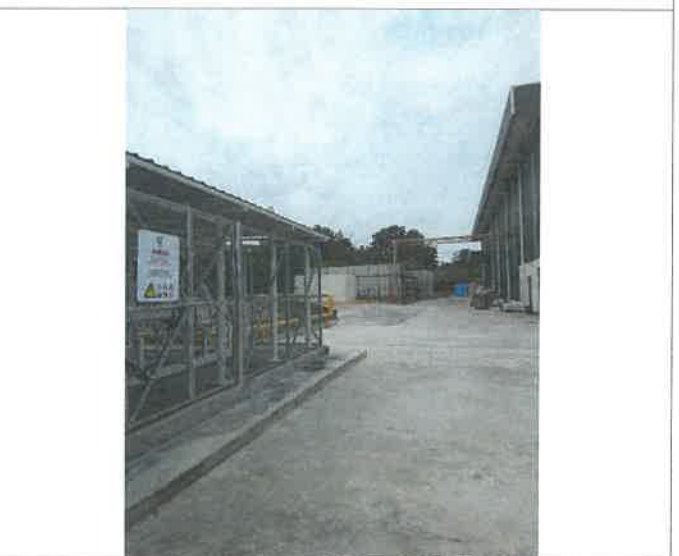
Avecena Glove's Gas Pipeline
