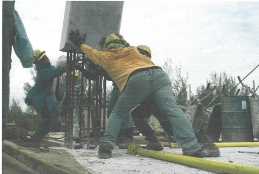
Foto 4.14: Sambungan tiang ke tiang
