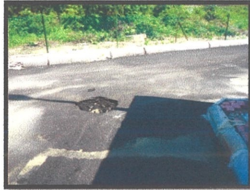
Gambarfoto 5.8 : Jalan berlubang akibat kebocoran paip bawah tanah
