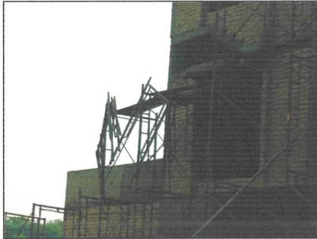
Gambarfoto 4.9 Perancah yang tidak siap dipasang
