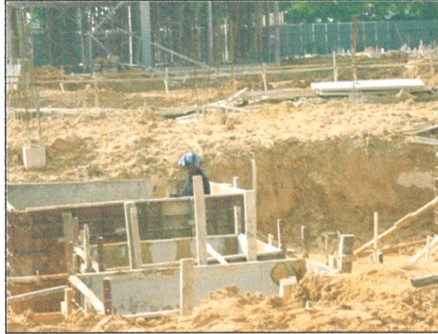
Gambarfoto 5.4 Pekerja tidak memakai topi keselamatan
