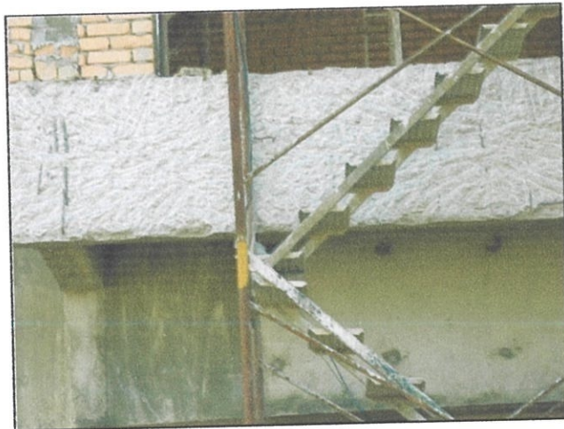
Gambarfoto 4.8 Tangga perancah yang tidak mempunyai pemegang
