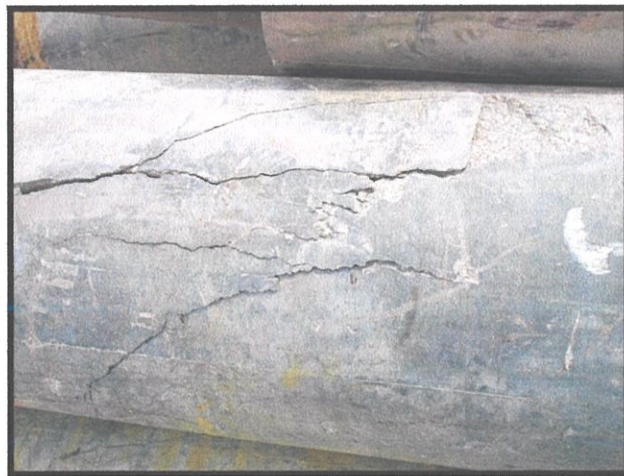
Gambarfoto 5.2: Rekahan akibat kegagalan pengendalian cara mengangkat cerucuk semasa penghantaran
