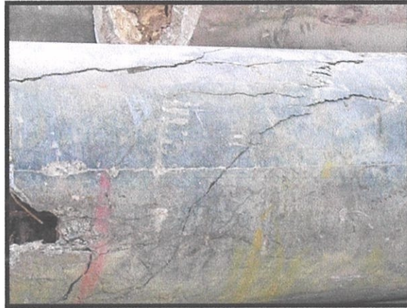
Gambarfoto 5.3: Rekahan akibat hentakan
