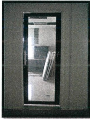
Gambar foto 3.10: Pintu aluminium tidak dapat ditutup
