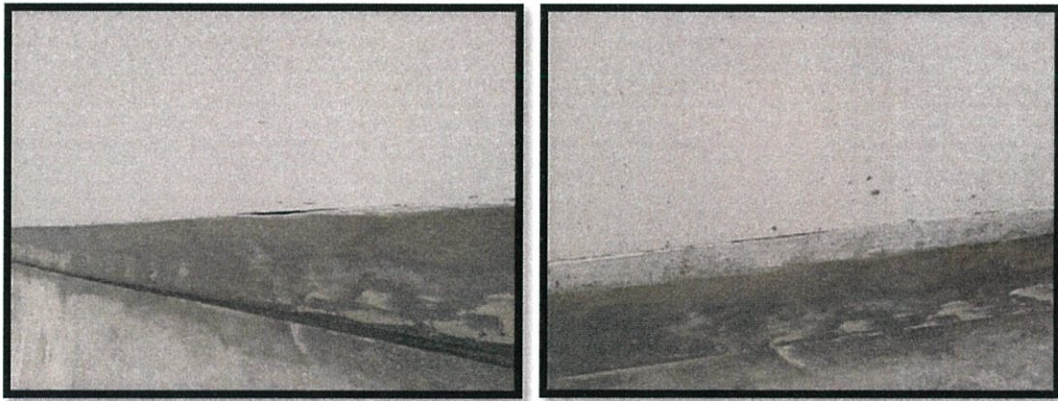
Gambar Foto 3.8: Kecacatan lapisan kalis lembap (waterproofing)
