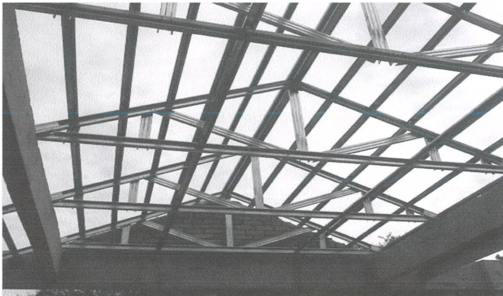
Gambar 3.9 :Menunjukkan batten pada bumbung ' carposh ' siap dipasang Foto Kredit: Ahmad Adzim (5 Dis 2011)
