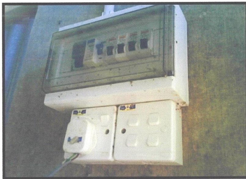
Rajah 5.4 Bekalan elektrik
