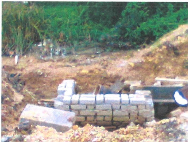
Gambar foto 4.4.3.1 Pembinaan sum longkang ditangguhkan
