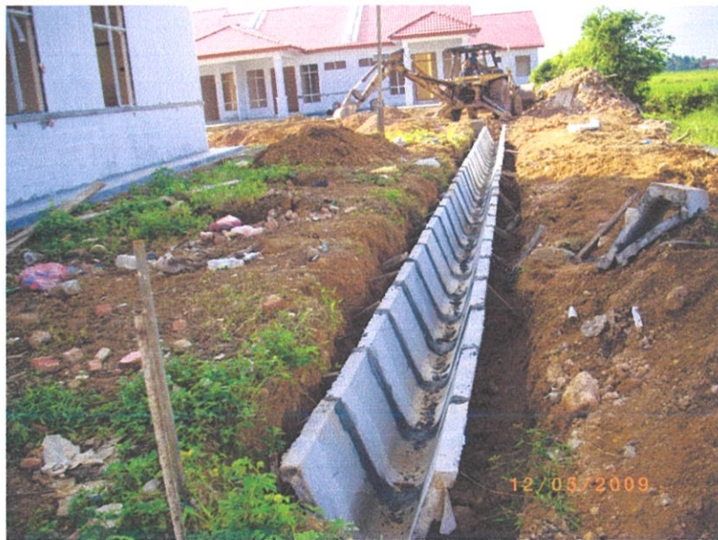
Gambar foto 4.4.5.1 Pemasangan longkang aras ketinggian tidak sama
