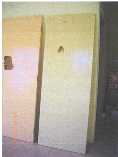
Gambar foto 4.2.4.1 Pintu PVC pecah
