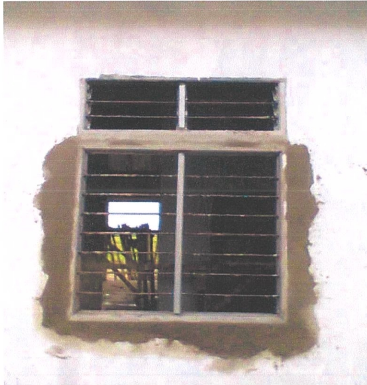
Gambar foto 4.2.1.1 Pemasangan kedudukan kerangka tingkap yang salah
