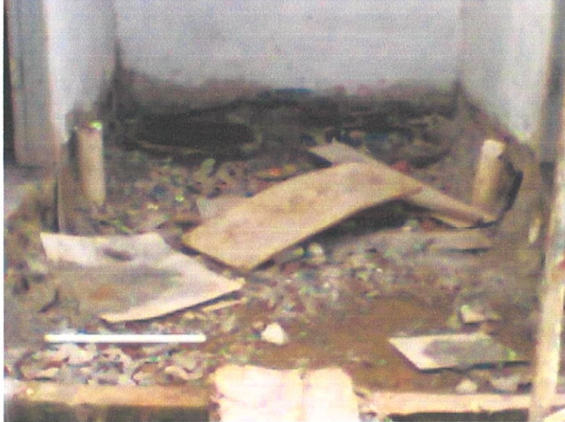
Gambar foto 4.3.4.1 Serpihan lepa memenuhi ruang manhole
