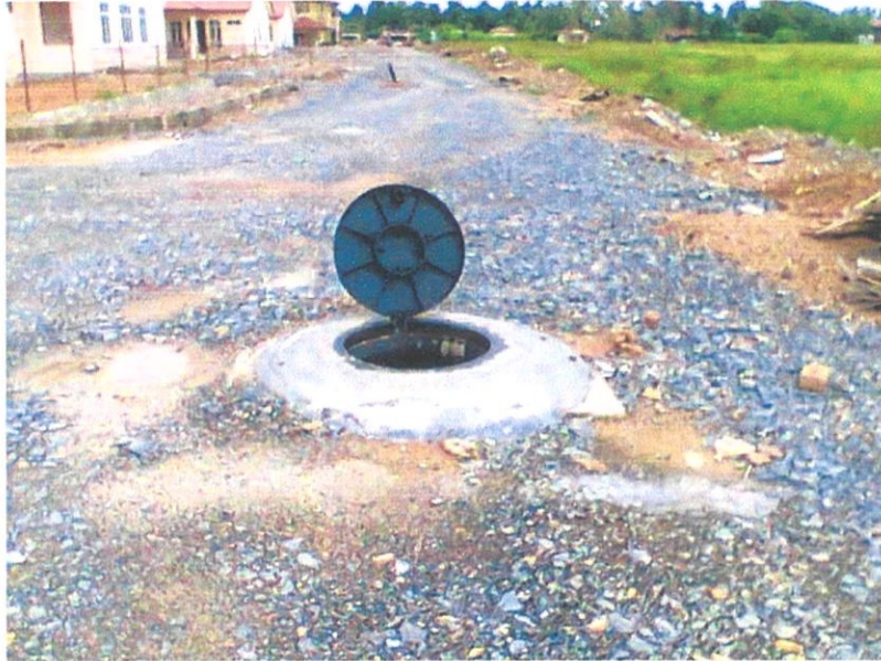
Gambar foto 4.4.2.1 Tudung tidak ditutup disepanjang jalan
