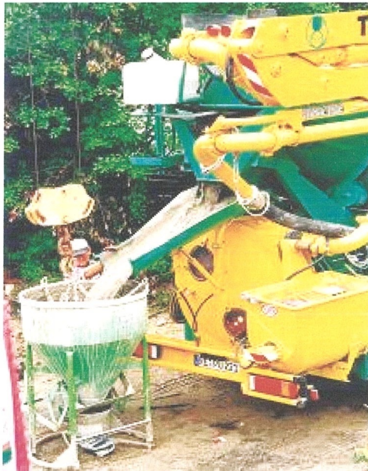
Gambar foto 3.3 Bancuhan konkrit dicurahkan ke dalam 'Concrete Pump' sebelum dipam ke kawasan yang hendak dikonkrit
