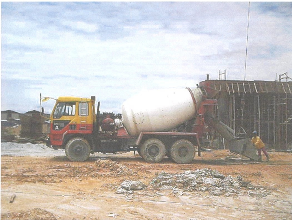
Gambar foto 4.8 Penghantaran konkrit siap bancuh perlu dijalankan secara sistematik supaya tidak berlaku kesulitan semasa kerja-kerja konkrit dijalankan.
