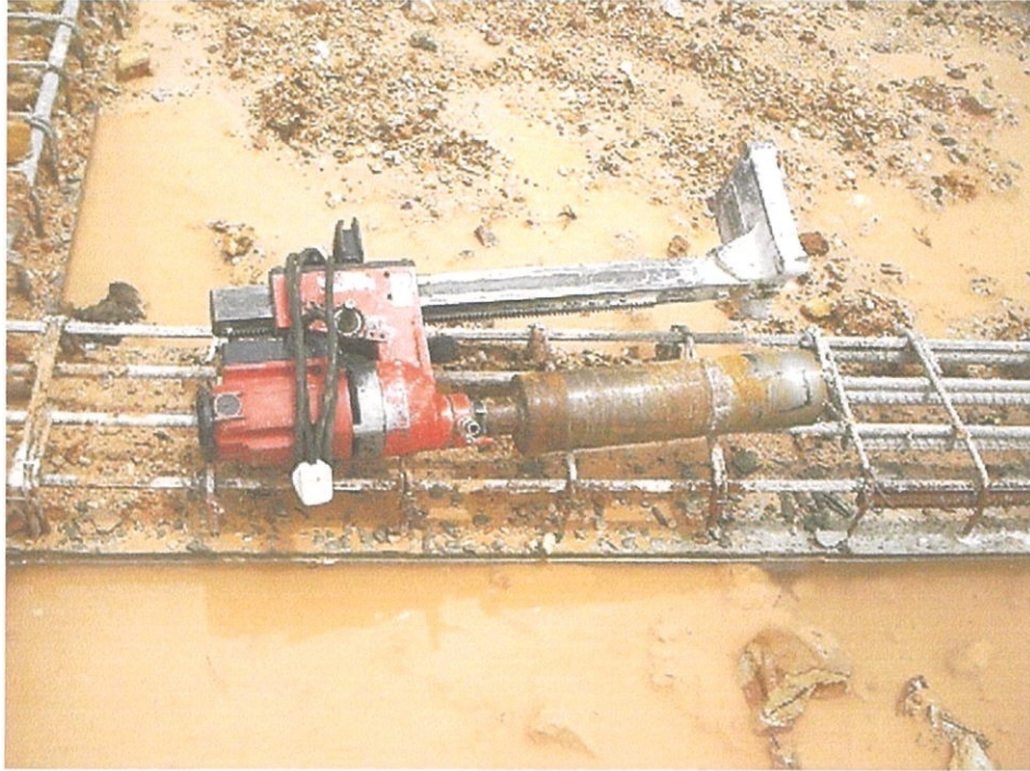
Gambar foto 5.5 'Coring Machine' digunakan untuk ujian ini.
