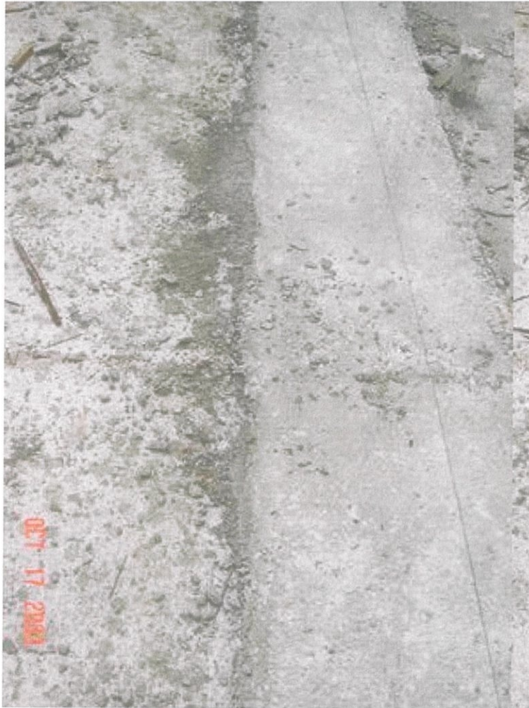
Gambar foto 5.0 Kelewatan penyudahan kerja-kerja konkrit menyebabkan kesan yang ketara pada sambungan antara konkrit
