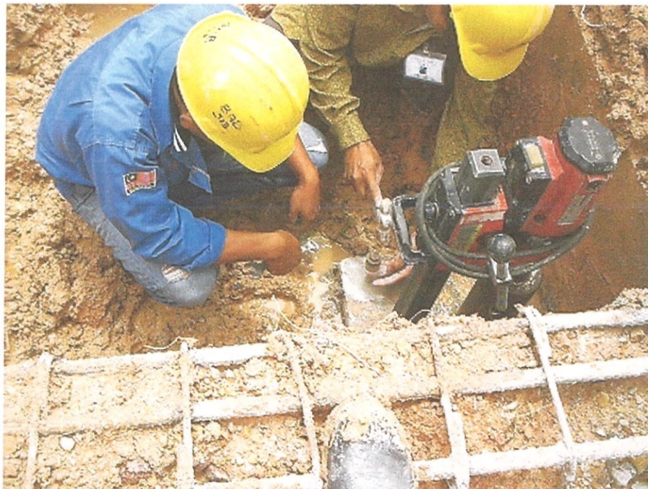
Gambar foto 5.6 Alat ini perlu dipasang dengan kemas dan kuat terlebih dahulu sebelum kerja-kerja penebukan konkrit dibuat. Skru digunakan bagi memperketatkan pemasangan alat tersebut.
