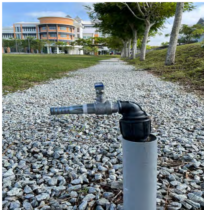
Gambarajah 13: Sistem paip yang disambung daripada tangki takungan SPAH di UiTM Kampus Dengkil
