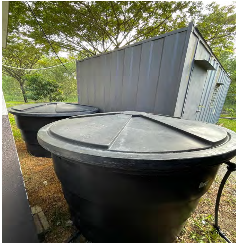
Gambarajah 12: Tangki simpanan air hujan dan kolam takungan UiTM Kampus Dengkil
