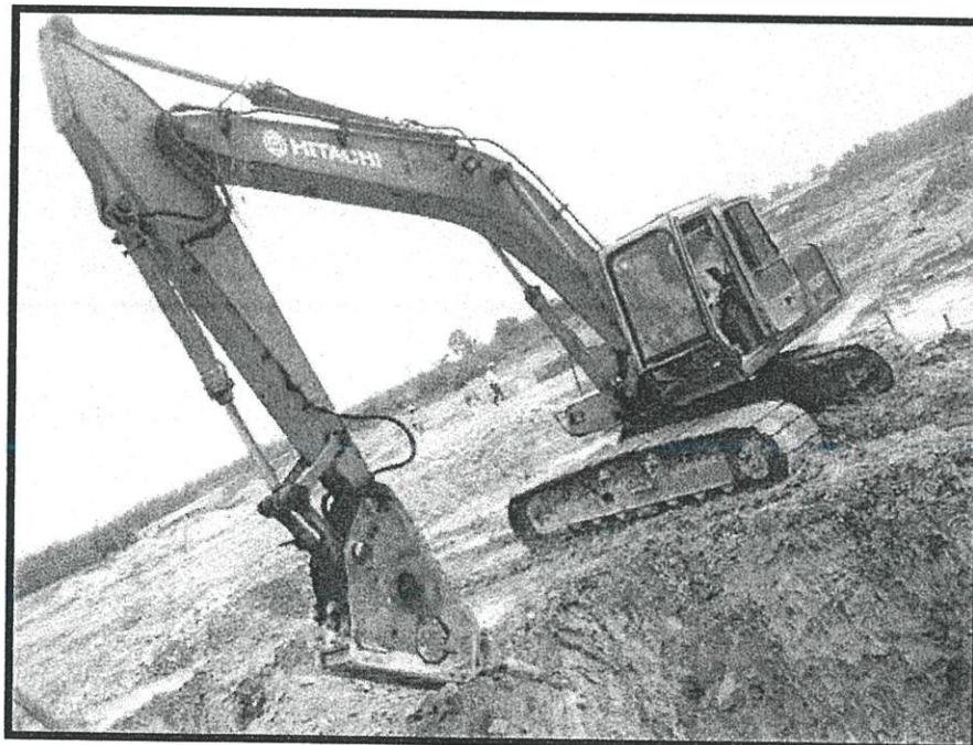
Gambar Foto 5.4 : Menunjukkan sebuah 'Breaker'
