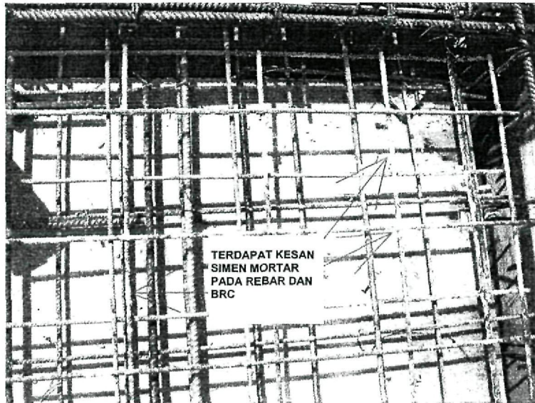
Foto 4.10 : Kelihatan kesan simen mortar pada kerangka besi
