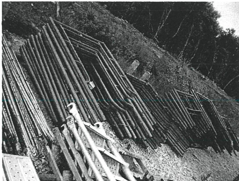
Gambarfoto 4.14 a: Kerangka perancah yang disusun mengikut saiz supaya memudahkan kerja pengiraan perancah untuk Site Inventory .
