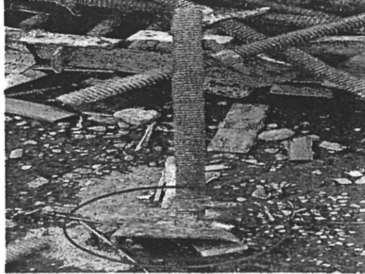
Gambarfoto 5.2.ii: U Head yang rosak akibat penyimpanan yang salah.
