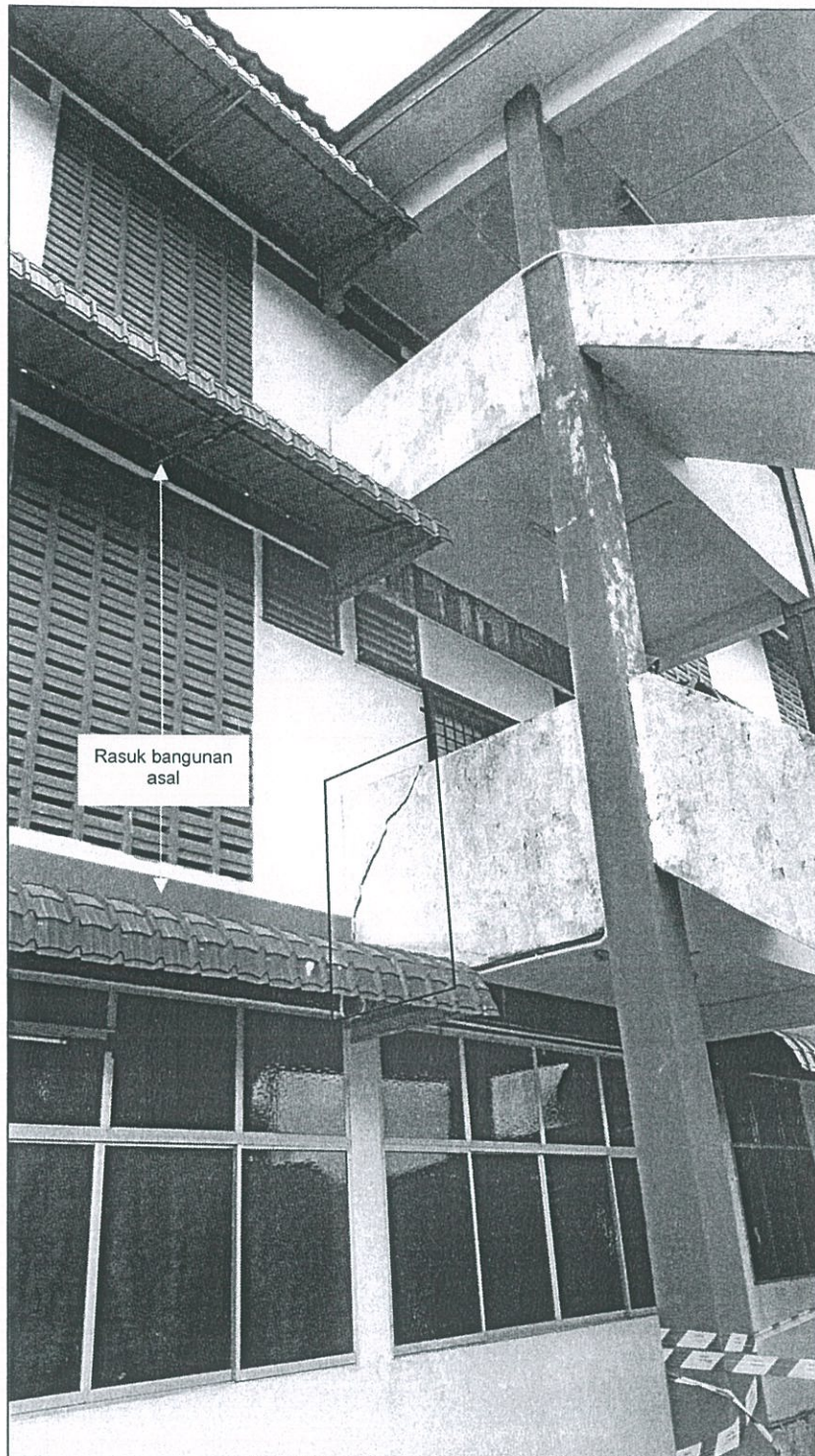
Gambar 5 : Pandangan dari luar menunjukkan keretakan pepenjuru pada dinding parapet tangga tingkat satu. Keretakan dikesan bermula dari pepenjuru rasuk bangunan asal.
