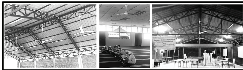
Rajah 4: Perkakasan Elektrik di Bangunan Kajian Kes; Melibatkan Lampu (10 unit), Kipas (6 unit) dan lain-lain Perkakasan
