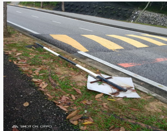
Gambar 12: Hazard yang dikenal pasti boleh membahayakan pengguna jalan raya.
